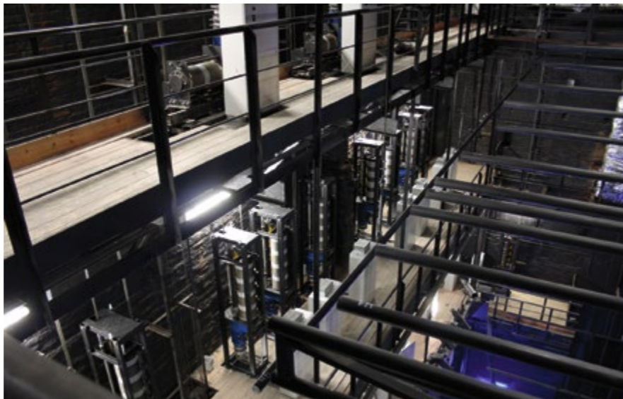
Лебедки на галереях. Вид сверху
