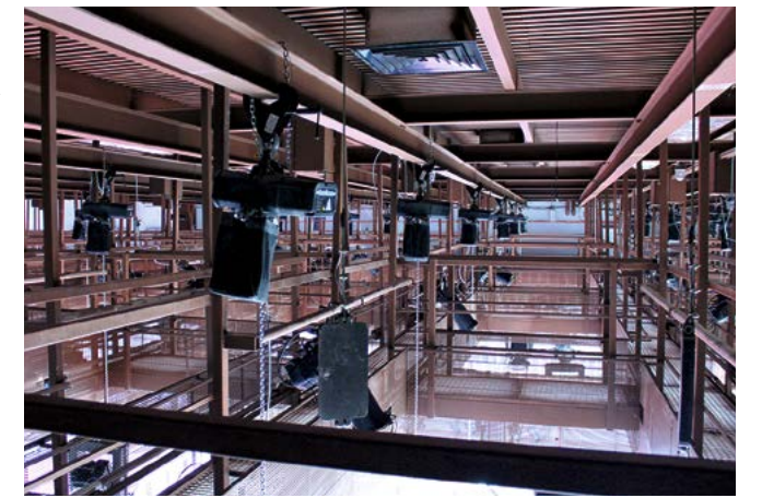
Переходные мостки колосников – удобный доступ к оборудованию
